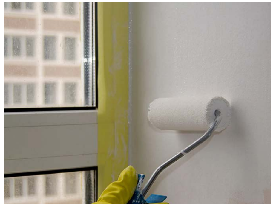
Wanneer condensatie het verfpoppervlak aantast, raakt deze beschadigd
