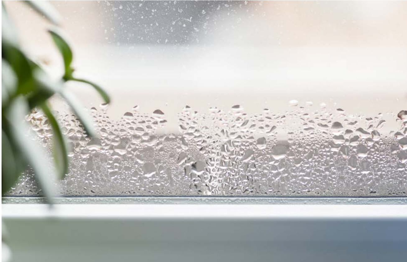
Wanneer condensatie het verfpoppervlak aantast, raakt deze beschadigd
